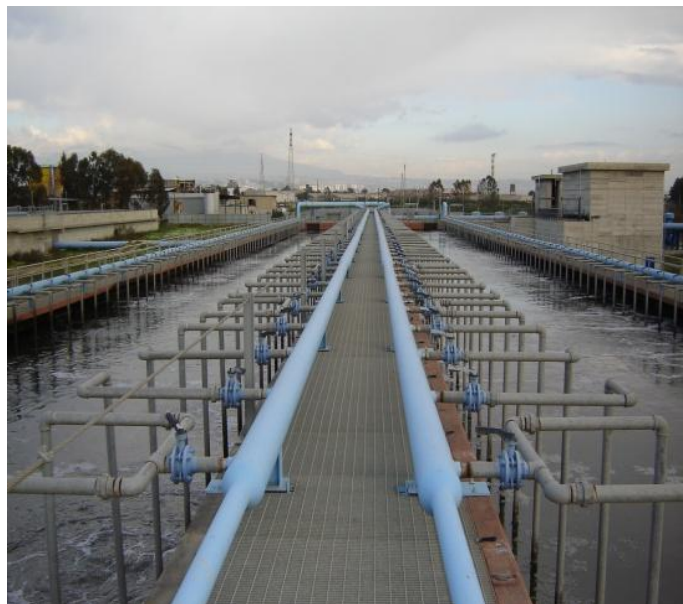
Impianto di depurazione “SIDRA” Catania
