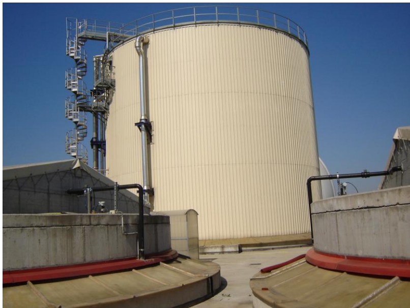
Il digestore anaerobico di Camposampiero Visita d'istruzione – Aprile 2008
